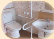
居室内 トイレ・洗面台
